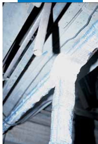
Пример разрушения бетонной конструкции
